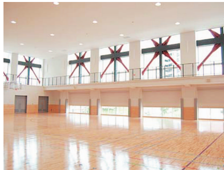
アリーナの全開口部に設置された耐震ブレース
