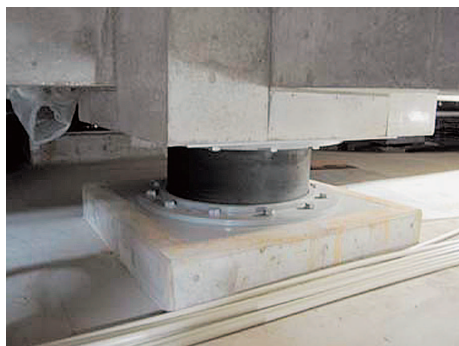
50センチは変位する免震支承
